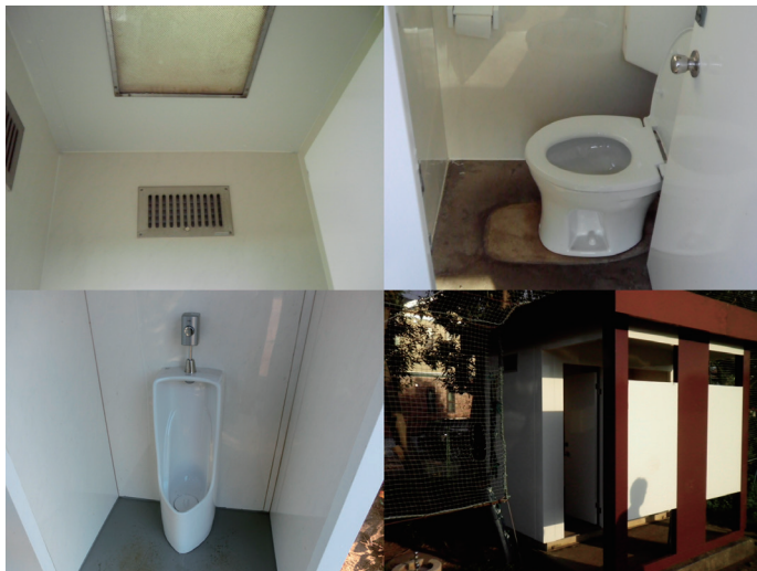
改修が完了した港南台第一中学校の第二グラウンドのトイレ
